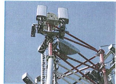
Zał. nr 1: Widok ogólny instalacji radiokomunikacyjnej.
