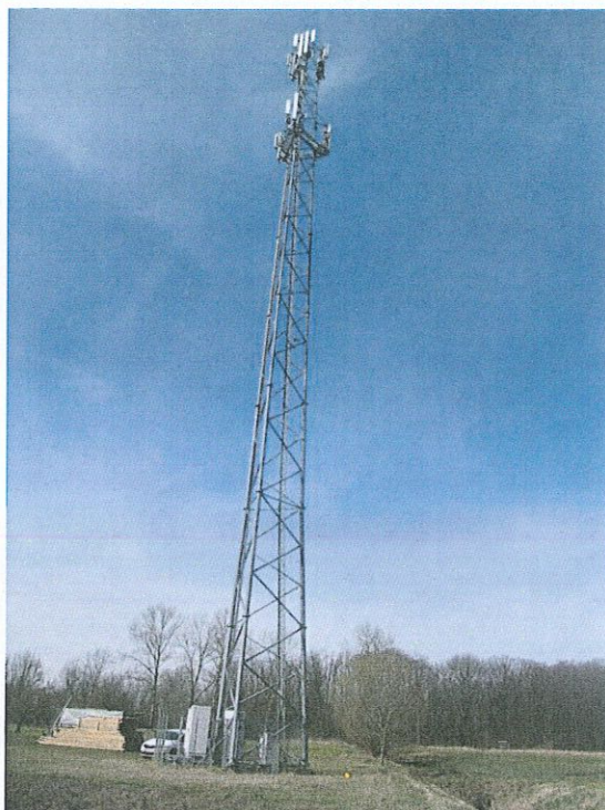
Zał. nr 1: Widok ogólny instalacji radiokomunikacyjnej.
