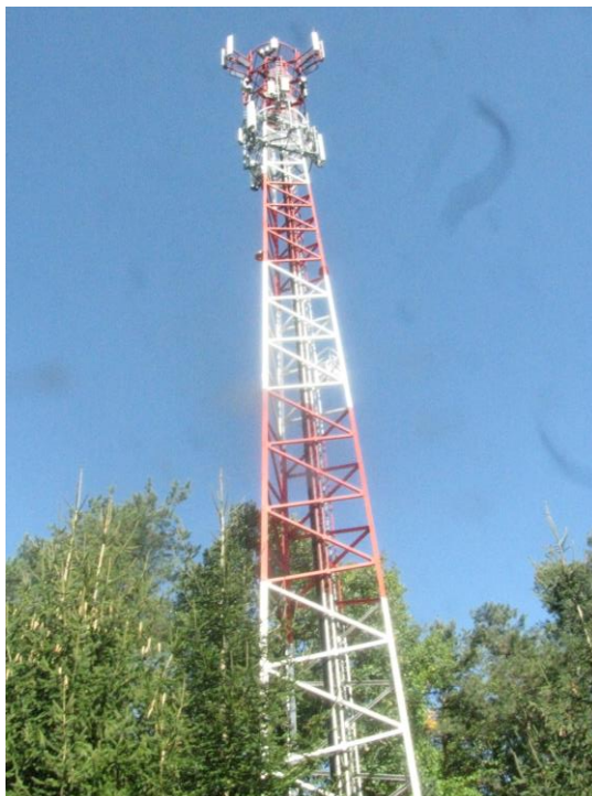
Zał. nr 1: Widok ogólny instalacji radiokomunikacyjnej.
