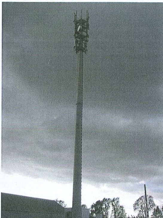
Zof. nr 1: Widok ogólny instalacji radiokomunikacyjnej.
