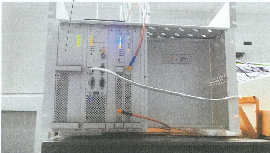
Urządzenia nadawcze stacji bazowej
